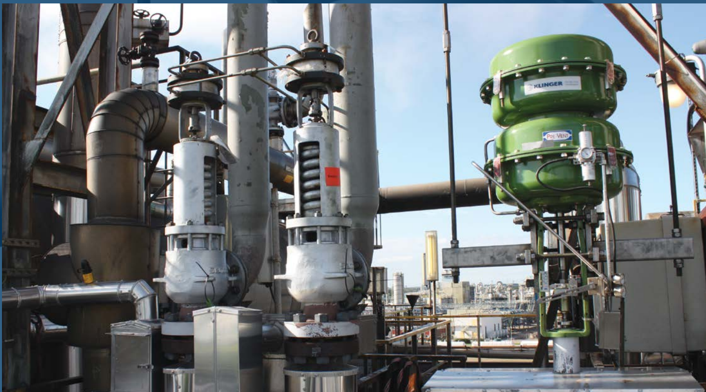
Klinger Regelafsluiter type Pre-Vent in de installatie
